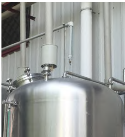
图 4.2-1 排空管有机废气捕集方式（企业其他厂区）
